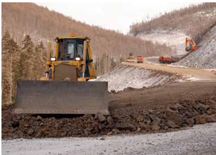
↑↑ Устройство рабочего слоя земляного полотна участка автомобильной дороги Хабаровск — Лидога — Ванино с подъездом к г. Комсомольск-на-Амуре км 179 — км 185.
