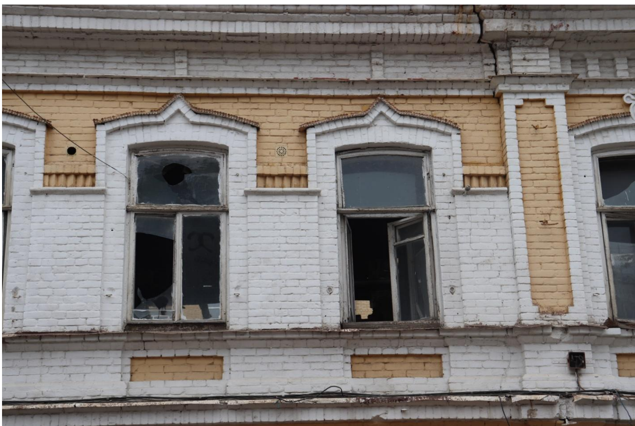
Фото 4. Фрагмент главного фасада. Оформление оконных проемов. Простенки с поребриком. Ниши в подоконной части. Дата фотофиксации 10.08.2021 г.
